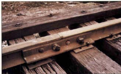
損壞型態：R1(鋼軌頭部碎片)，嚴重程度：L
