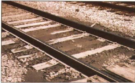
損壞型態：B6(噴泥)，嚴重程度：M
