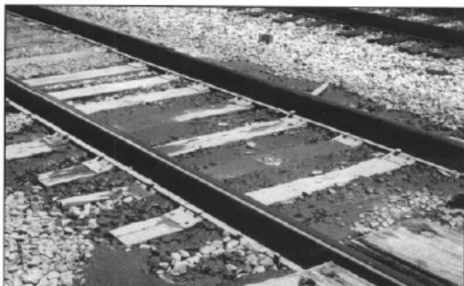
損壞型態：B6(噴泥)，嚴重程度：M
