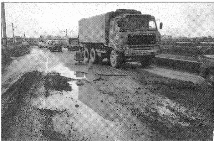
五股疏洪道快速道路才開放五天，路面已是千瘡百孔。記者陸克毅／攝影
